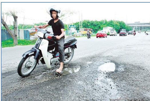
Seorang penunggang motosikal hampir terjatuh setelah mengelak kenderaannya daripada jalan raya yang berlubang dan berlokap di Jalan Utama, Kampung Lindungan, Kuala Lumpur. Di sepanjang Jalan Kepong dan Jalan Kuchai Lama pula, senario jalan berlubang, retak dan tidak rata sudah menjadi pemandangan biasa.
