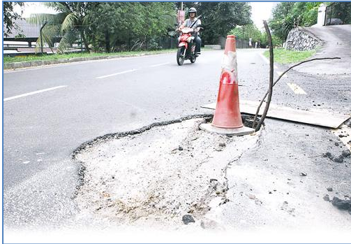
SEORANG penunggang motosikal melalui jalan yang rosak di Jalan Riong, Bangsar, Kuala Lumpur, baru-baru ini.
