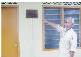
Osman Mamat menunjukkan tempat meter elektrik rumah PPRT miliknya yang masih kosong di Kampung Alur Tembesu, Dungun semalam.
