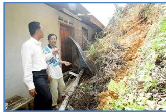
MUSTAFA (kiri) meninjau tanah runtuh di belakang rumah Abu Bakar di Rumah Rakyat Panchor, Seremban.
