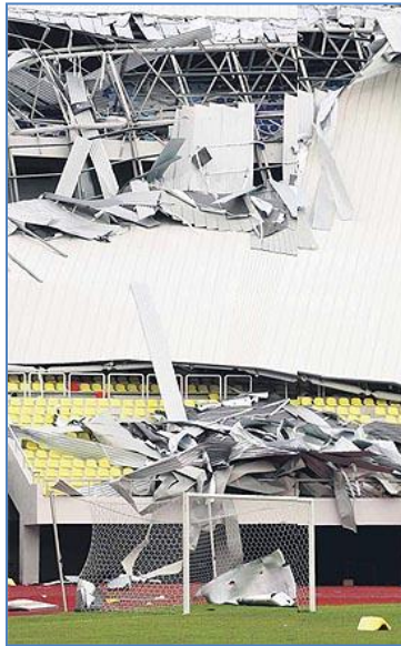
KEADAAN Stadium Sultan Mizan Zainal Abidin selepas bumbung runtuh.
