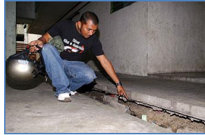
SEORANG penduduk menunjukkan tanah mendap dan keretakan di PPR Lembah Subang.
