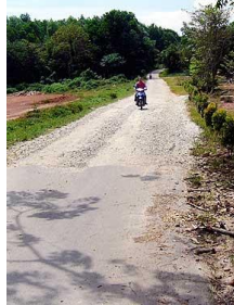
KEADAAN permukaan jalan masuk ke Kampung Pengkalan Besar yang rosak ditambah dengan batu kerikil.
