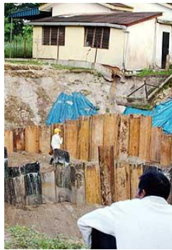
BAHAGIAN dapur rumah Syed Shahron seolah 'tergantung' akibat kerja pembinaan tebing sungai.
